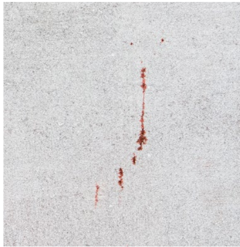
Parte inspeccionada por líquidos penetrantes (colorante rojo visible)
