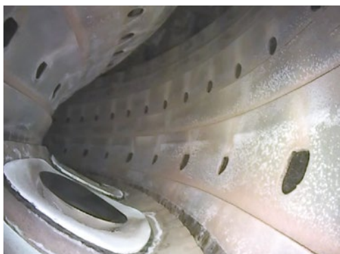
Camera di combustione
