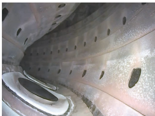
Chambre de combustion
